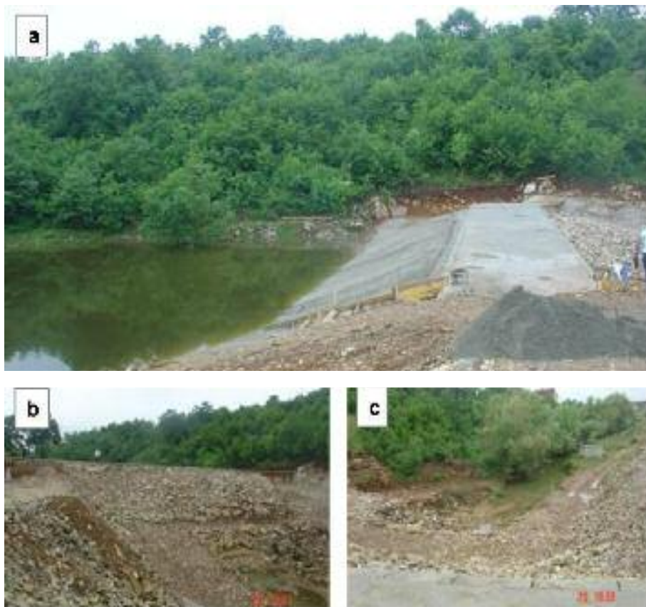
Fig. 33. Degradimi i shtratit të lumit Mirusha (29.05.2009)
